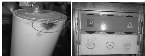
(c) 熔管支架放电局部图 (d) 未烧毁的PT柜内图片
