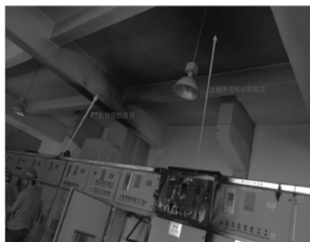
图1 被烧开关柜的外部图
